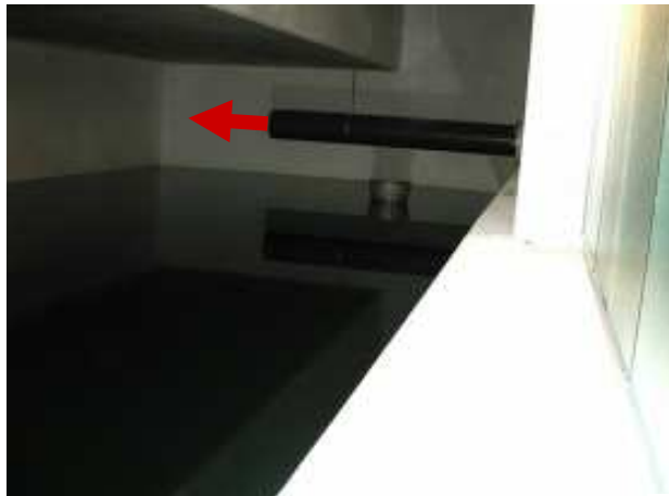
Gaine d'aération horizontale avec légère contrepente
