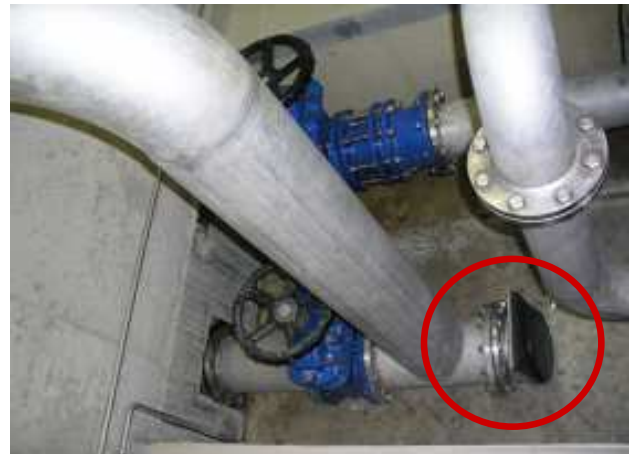
Trop-plein muni d'un clapet de non retour
